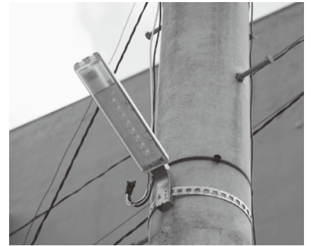
【LED化された防犯灯】
