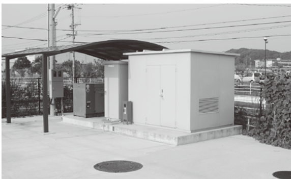
【流域下水道の勝野ポンプ場】
