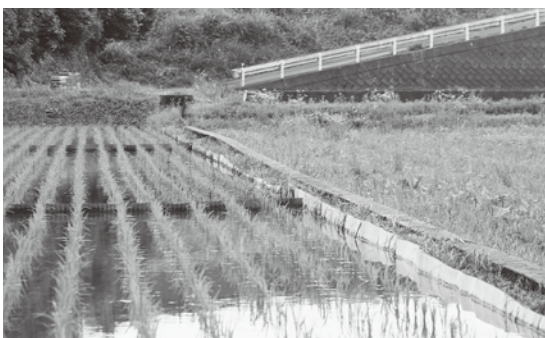
畦畔が沈下している復旧田
