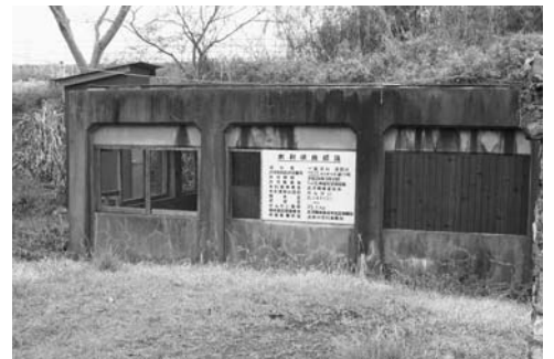
小竹駅付近にある川端ポンプ
