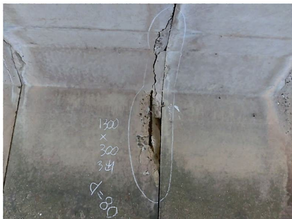
橋梁の損傷事例(井田橋)
